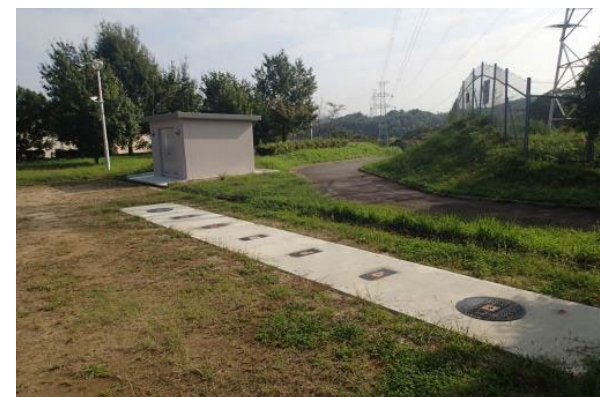
写真7 マンホールトイレ
