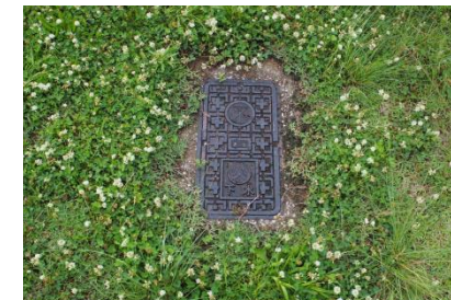
写真1 南港中央公園内の 芝生地に設置される マンホールトイレ
