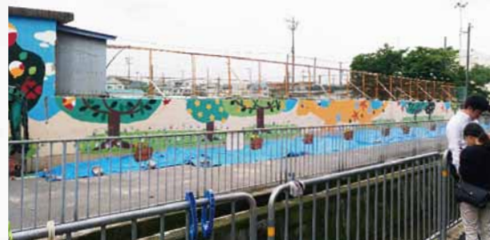
ブロック塀の倒壊現場
