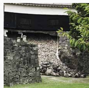
崩壊した熊本城
