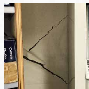
亀裂が入ったコムスタカ事務室の壁
