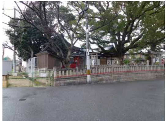
写真4 鷹合神社の石垣の不等沈下
